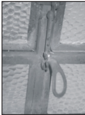
Figura 3. Conjunto de janelas basculante tomadas de ferrugem (E4) Fonte: Pesquisa de campo (2008)
